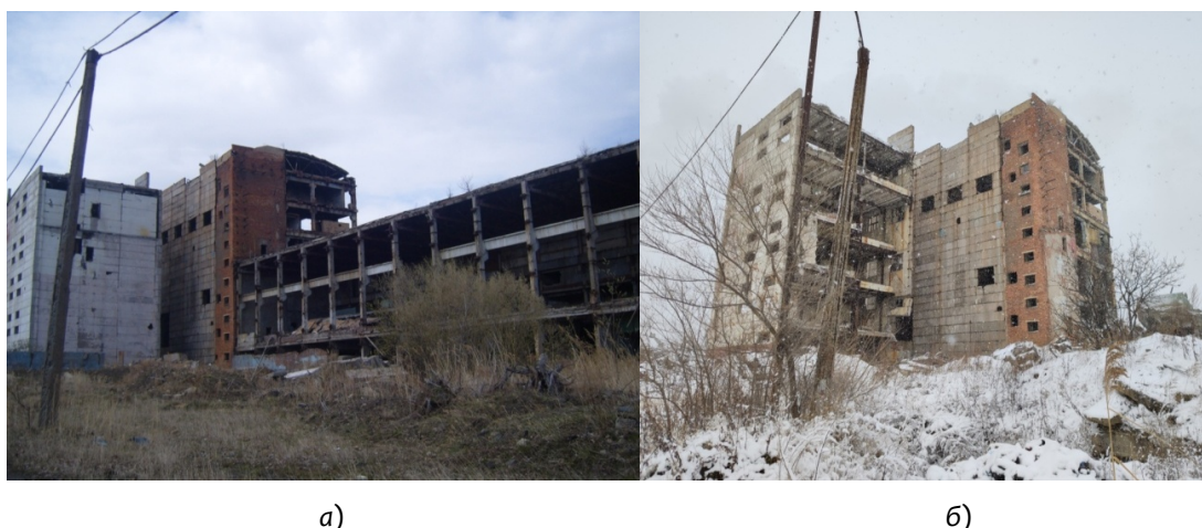
Рис. 3. Разрушенный корпус ЦКК: а – сентябрь 2008 г.; б – ноябрь 2019 г. Авторы фотографий: 2006–2008 гг. – Р. А. Миронов; 2016–2019 гг. – А. Е. Полещук
